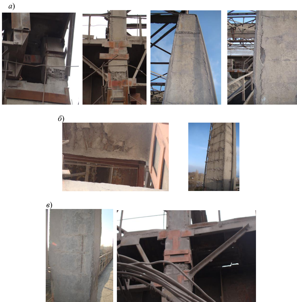
Рисунок 14 – Оголение рабочей арматуры
