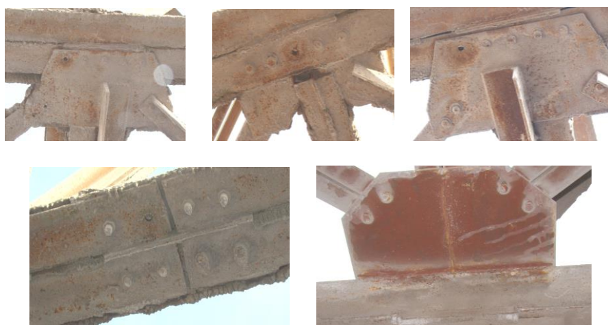
Рисунок 20 – Отсутствие болтов в узлах крепления фасонки связей к нижнему поясу фермы Ф6 и отсутствие болта в центральном стыковом узле нижнего пояса фермы Ф6 и в узле крепления фасонки связей в 12 м от ряда А к нижнему поясу фермы Ф4
