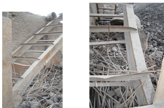
Рисунок 18 – Изогнутая наружу внутренняя ветвь вертикальной связи ВС В/ 3-4 между колоннами у оси 4
