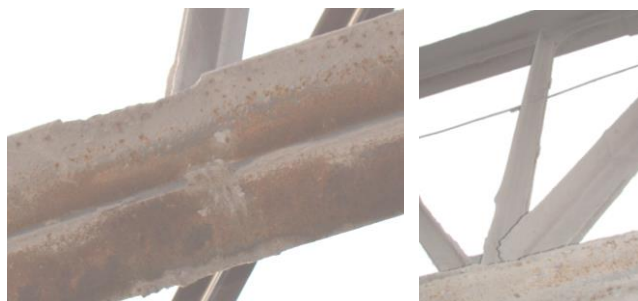
Рисунок 22 – Вырез в отстоящей полке уголка первой панели от ряда Б нижнего пояса фермы Ф5 и местное искривление в отстоящей полке уголка со стороны оси 5 первой от ряда Б стойки фермы Ф4
