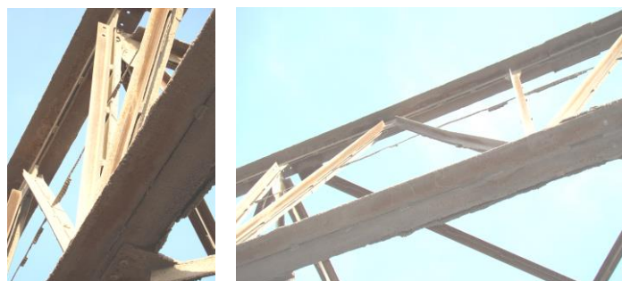
Рисунок 19 – Общее искривление стойки в четвертом узле НП от ряда Б фермы Ф6. Разрушение сухарей на стойке и в нижнем поясе фермы и десятого раскоса от ряда Б фермы Ф6
