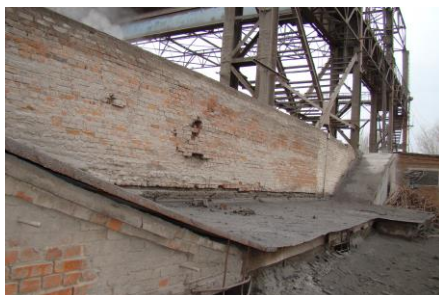
Рисунок 26 – Разрушение кирпичной стены по ряду Б в осях 2–3
